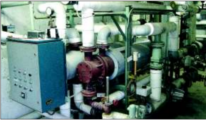
Rohrbündelwärmetauscher aus dem Jahre 1984 - Energieverluste vorprogrammiert.
